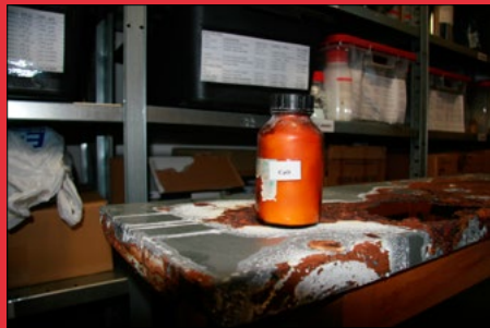
Korodējis un nestspēju zaudējis plaukts
